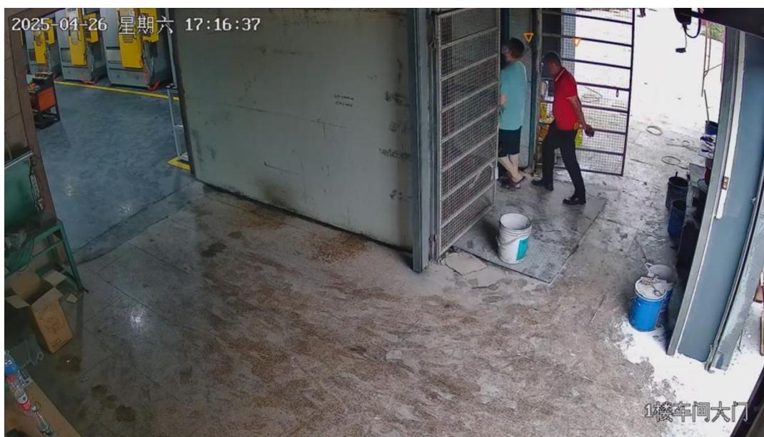
图 13 进入一楼简易升降设备液压泵站处
