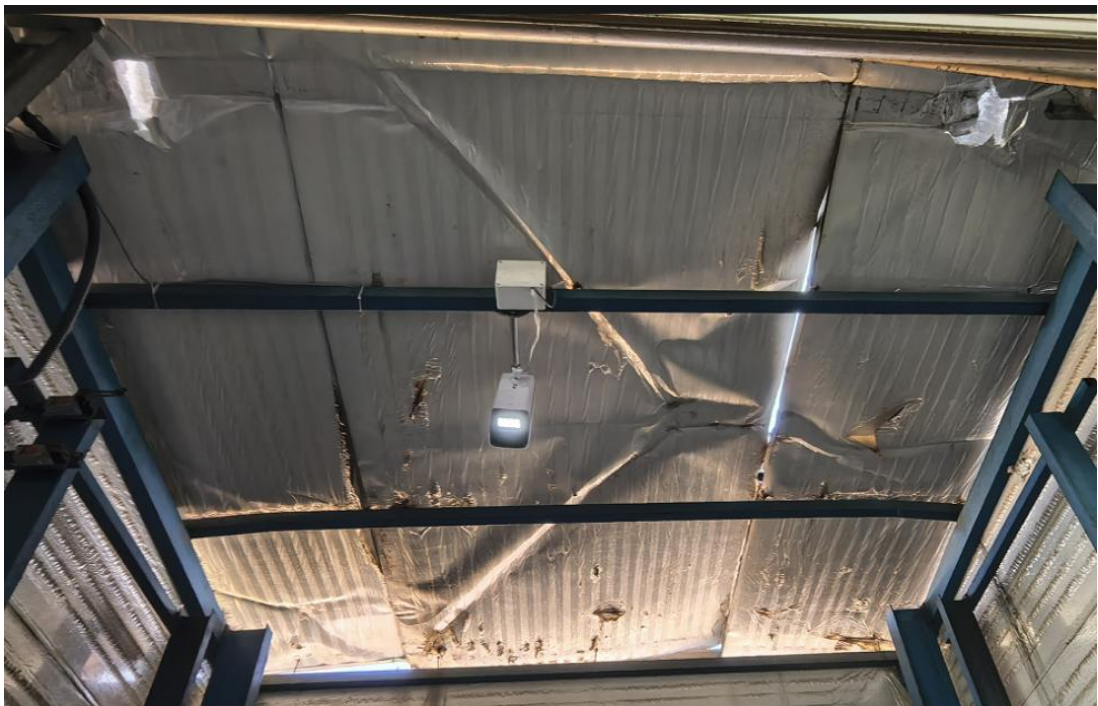
图 8 顶棚被冲顶后撞穿的孔洞
