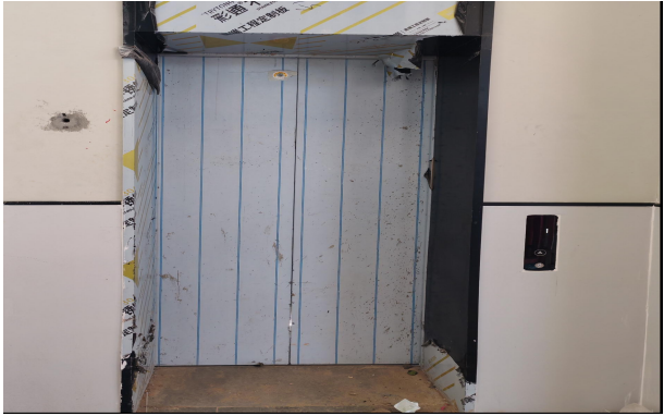
图 2 电梯整体外观
