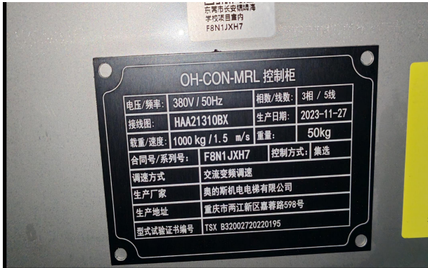
图 1 电梯控制柜铭牌
