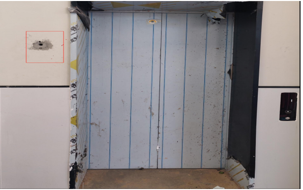
图 4 1 楼层门外消防迫降开关 安装位置
