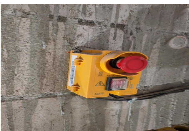
图 10 底坑急停开关未动作
