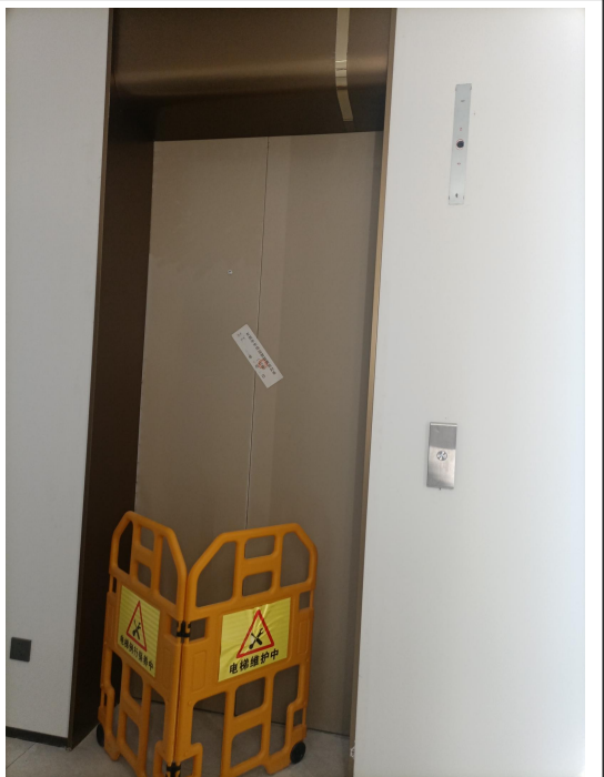
图 2 涉事电梯负二楼层门整体外观
