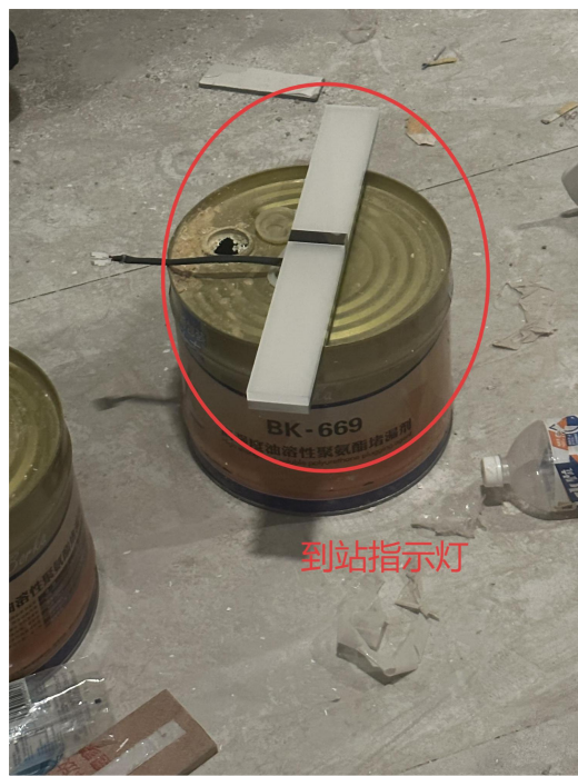
图 5 涉事电梯未完成安装的到站指示灯
