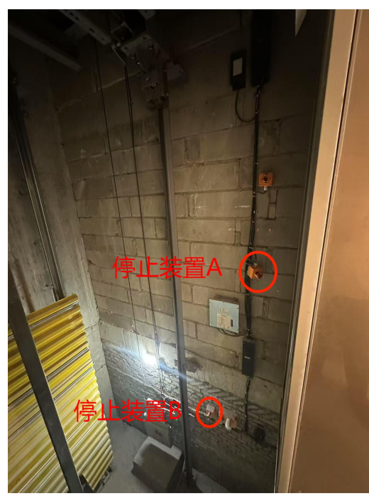
图 6 涉事电梯底坑停止装置
