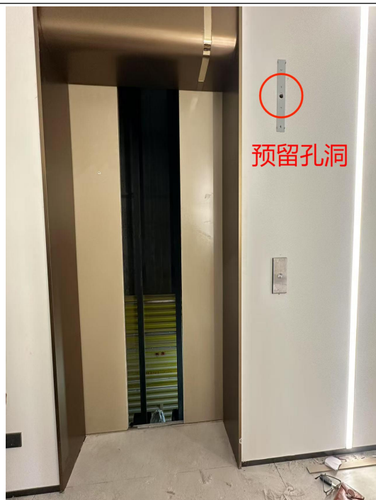
图 11 事故电梯层门外到站指示灯接线端口预留孔洞
