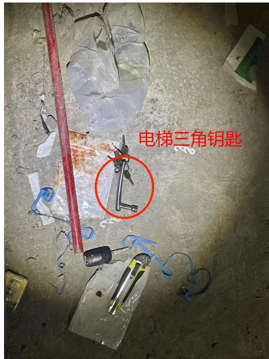
图 9 涉事电梯底坑地面上的电梯三角钥匙
