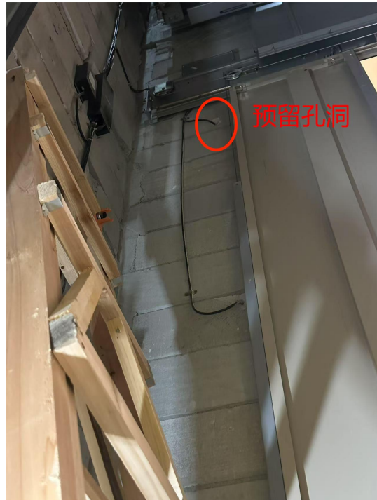
图 10 涉事电梯井道内到站指示灯接线端口预留孔洞
