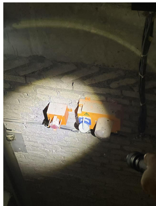
图 8 涉事电梯底坑地面上的停止装置 (停止装置 B)
