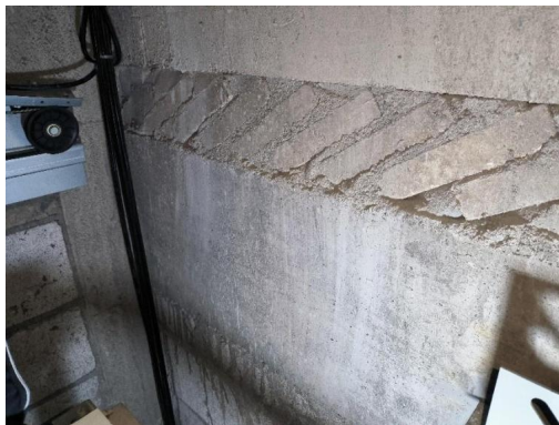
图 18 15 层左侧井道壁上的擦痕
