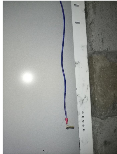
图 17 15 层紧急开锁装置拉绳固定端脱落
