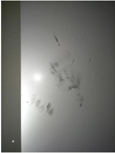
图 16 15 层层门井道侧面板上的油迹掌印
