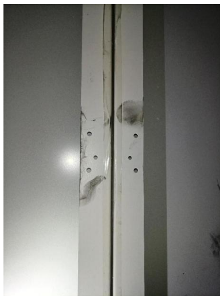
图 15 15 层层门井道侧折边上的油迹抓痕
